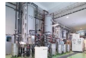
イオン交換樹脂再生設備
