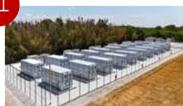
加西メガパワー蓄電所（兵庫県加西市） 蓄電コンテナ数：20台 / 54.84 MWh 事業者：株式会社上組
