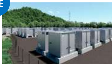
福岡県筑前町蓄電所（福岡県朝倉郡） 蓄電コンテナ数：102台 / 230.1 MWh 出資者：三菱地所・伊藤忠商事・東京センチュリー
