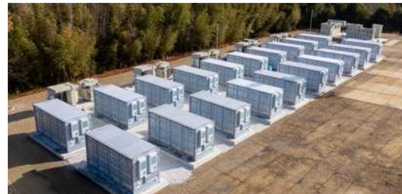
昨年導入した 特高蓄電所の例
